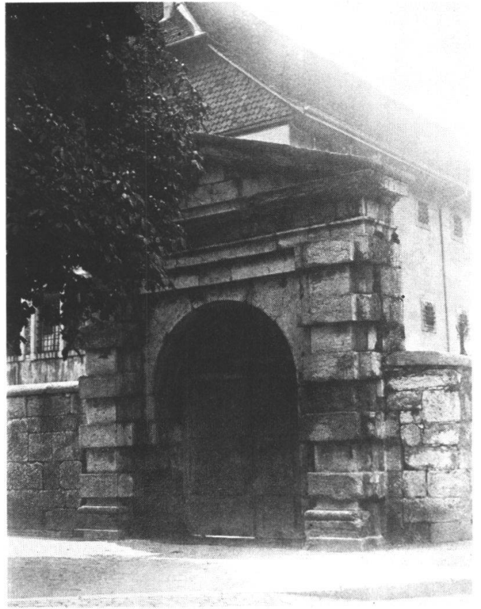
Abbildung 32 Das Mittelportal des ehemaligen äusseren Berntors in seiner Zweitverwendung als Eingangstor in den Gefängnishof
