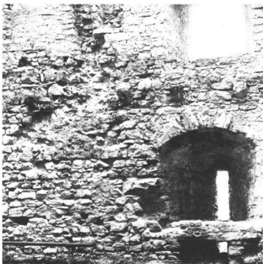
5 Gilgenberg. Mauerausbrüche im Innern des Palas
