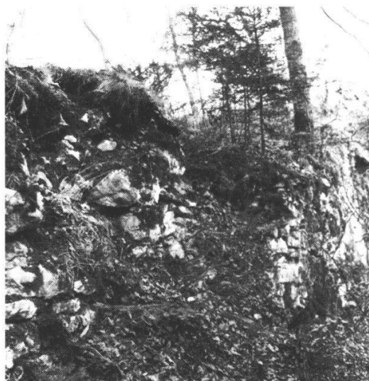
6 Gilgenberg. Zerfallene Stützmauer am Zugangsweg
