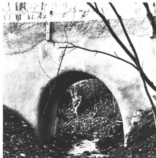
332 Das Aquädukt nach einer neuzeitlichen Behandlung
