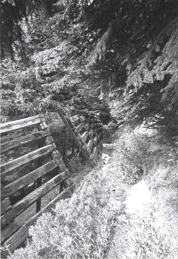
Abb. 48: Stützwerke aus Eisenbahnschienen und -schwellen, wie sie am Kirchberg häufig angewendet wurden, September 2017. (eigene Aufnahme)
