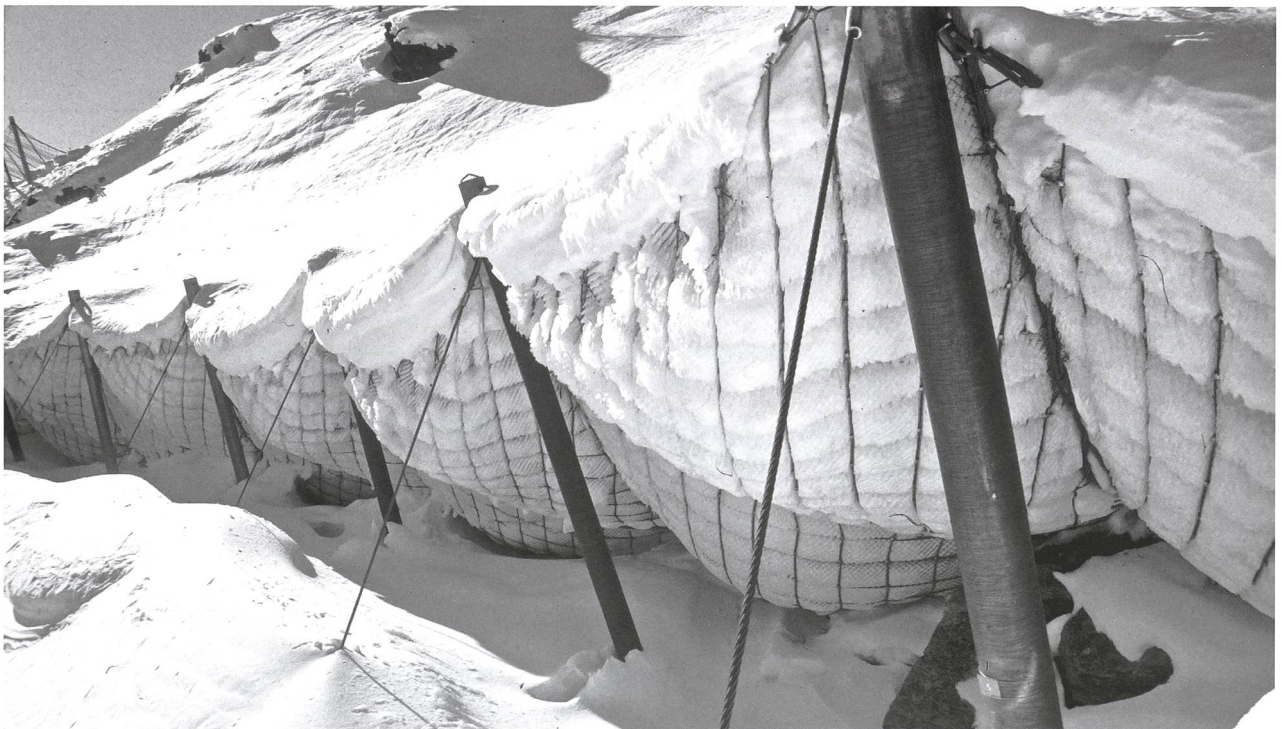
Abb. 5: Schneenetztützwerk aus dreiecksförmigen flexiblen Drahtseilnetzen; Lawinverbauung Duchli, Dischmatal. (Fotografie: Stefan Margreth, WSL-INSTITUT FÜR SCHNEE- UND LAWINENFORSCHUNG SLF: https://www.slf.ch/de/ueber-das-slf/portrait/geschichte/lawinenschutz.html , 13.12.2017)
