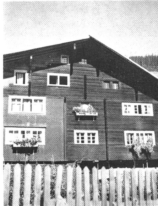
Foto 33 Zur Gewinnung zusätzlicher Kammern wird manchmal ein Dachflügel gehoben: das Haus steht schief. Ein Beispiel schlechter Aufstockung in Rueras (Tujetsch)
