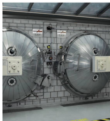
Papersave swiss Anlage, Wimmis. Beide Kammern sind geschlossen. Die Anlage ist in Betrieb.
