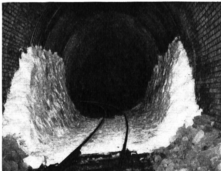
Schnee als Frostschutz in Tunnels. Das aus der Tunnelwand rinnende Wasser fließt hinter der Schneeschicht in die Kanalisation. Dadurch wird die Eisbildung verhindert
