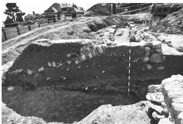
Fig. 27. Nyon VD, Vy-Creuse, parcelle 1473, vue sud-ouest de la démolition du mur de terrasse effondré dans la pente. Photo Archeodunum SA.
