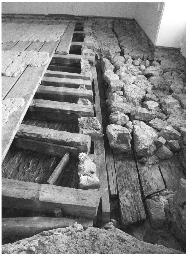
Abb. 57. Murten FR, Schloss. Im Hintergrund die Abbruchkrone. Gut sichtbar die Vormauerung (ab 1255) und der Mörtelgruss des Tonplattenbodens (1735/36). Foto AAFR, Ch. Kündig.
