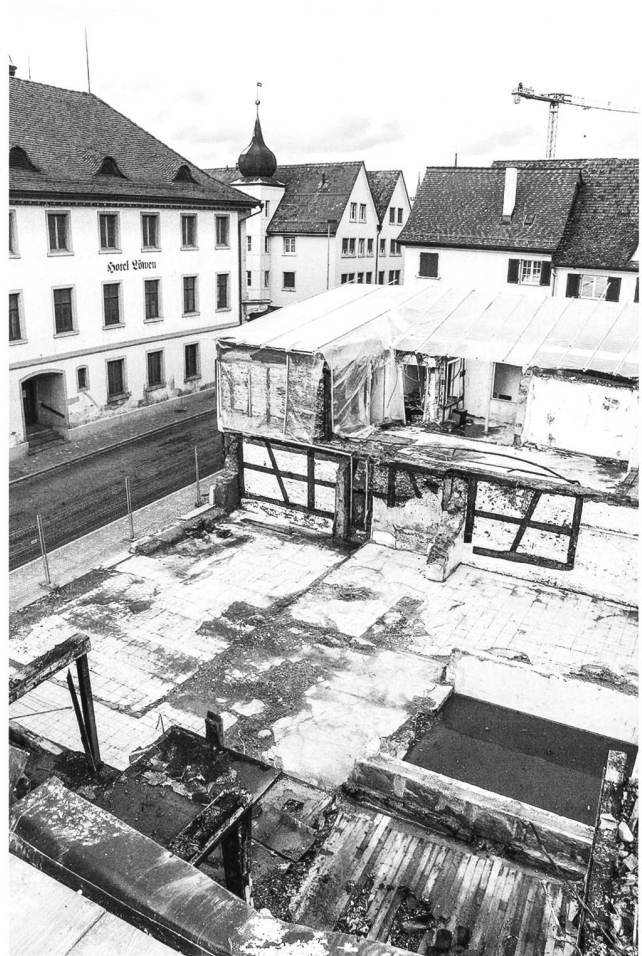
Abb. 57. Steckborn TG, Kirchgasse 2/Seestrasse 99-107. Blick vom Obergeschoss des Hauses an der Seestrasse 107 auf die Brandstelle nach dem teilweisen Rückbau der Häuser. Foto Amt für Archäologie TG.
