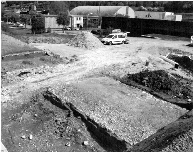
Fig. 35. Porrentruy JU, Sous Roche de Mars. Tronçon de la voie romaine. On observe à gauche sa coupe et son insertion stratigraphique au pied d'un talus. Photo OCC/SAP JU.
