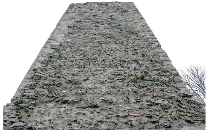
Abb. 25. Laufenburg-Schlossberg. Die Südfront besteht im unteren Bereich aus einer Mauer im Ährenverband. Foto F. Tortoli.
