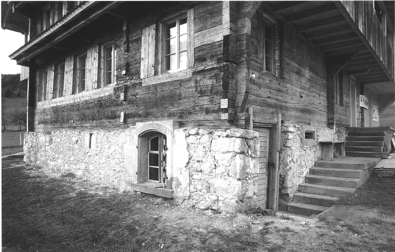
Abb. 58. Unterägeri ZG, Unterblacki. Der Kellersockel und der darauf ruhende, ins Jahr 1509/10 datierte Blockbau kurz vor Abschluss der Restaurierung. Foto KA ZG, M. Camenzind-Nigg.
