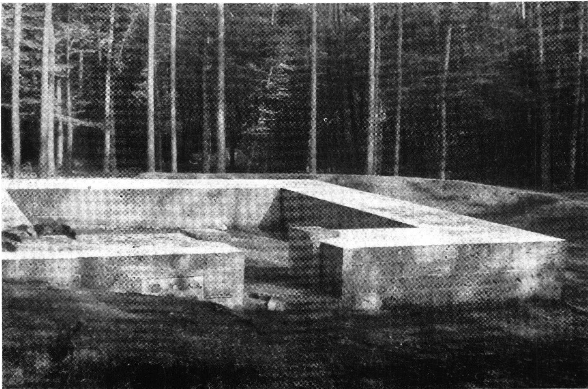
Taf. XXI, Abb. 1. Ellikon a. Rh. Römische Warte mit Tuffsteinverkleidung, fertig konserviert (S. 122)
