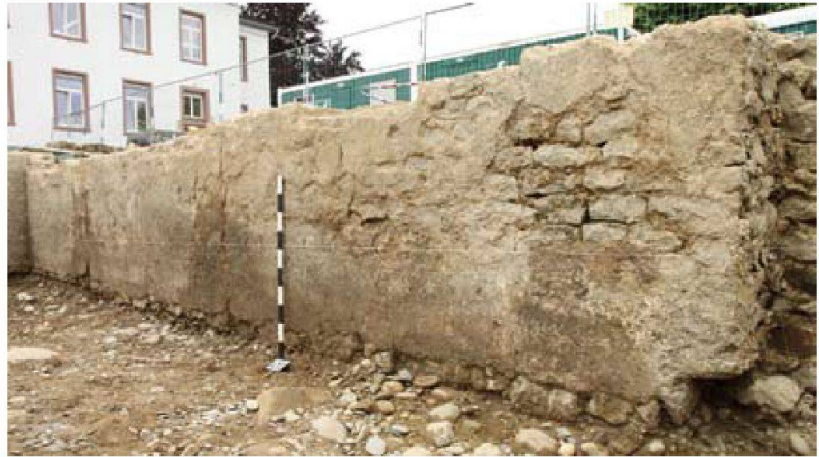
► Abb. 21: Kaiseraugst AG, Autoeinstellhalle Löwen (Grabung 2010.001). Blick von Südosten auf die nördliche Kellerwand MR 30, deren Ziegelschrot-Verputz noch ziemlich gut erhalten war. Stellenweise ist noch der Endverputz aus Kalkmilch sichtbar. Ganz rechts im Bild erkennt man die westliche Aussparung für die Holzschwelle.
