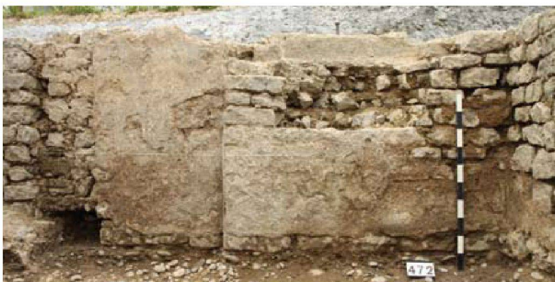
◀ Abb. 18: Kaiseraugst AG, Autoeinstellhalle Löwen (Grabung 2010.001). Der östliche Abschluss des Kellers mit allen baulichen Einzelheiten: links im Bild das (verputzlose) Negativ des Türrahmens und die grosse Aussparung für die hölzerne Schwelle, mittig der markante und unerklärliche vertikale Absatz und rechts davon die Nische mit einem römerzeitlichen Ausbruch darunter. Blick von Westen.
