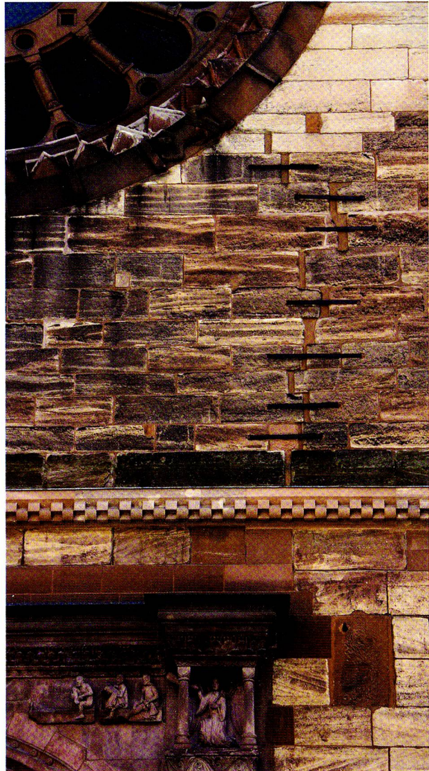
Abb. 4: Basel, Münster-Nordwestfassade am Querschiff über der romanischen Galluspforte. Das bei der Bevölkerung bekannteste Zeugnis des grossen Erdbebens vom 18. Oktober 1356 ist der klaffende Riss zwischen den Sandsteinquadern, der im Zuge der gotischen Reparaturarbeiten mit eisernen Klammern zusammengehalten wurde.
