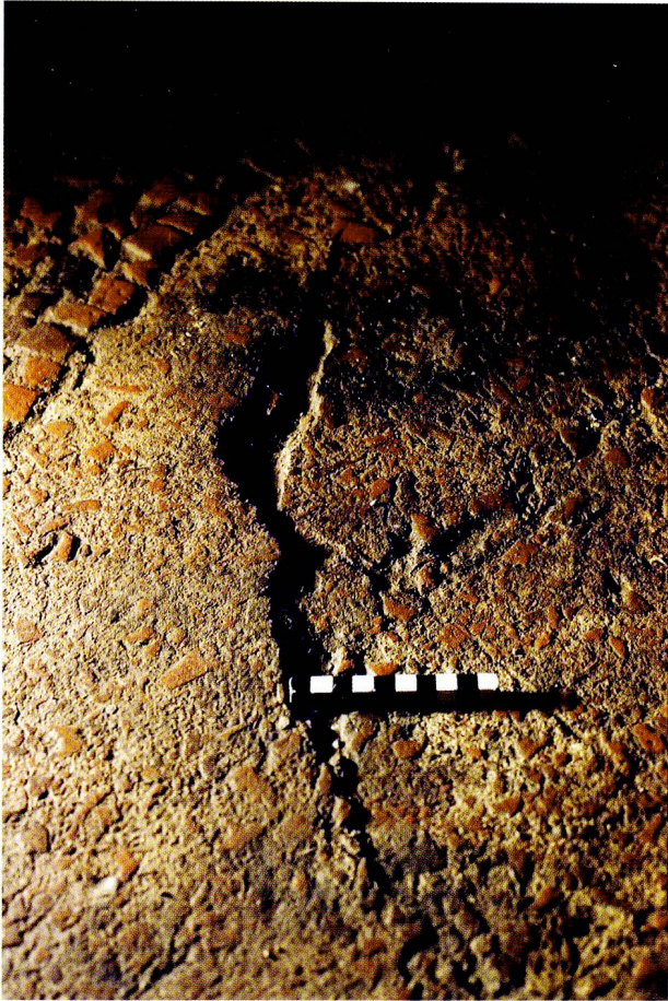
Abb. 25: Augusta Raurica, Region 2A westlich des Theaters. Durch Absacken des Untergrundes entstandener Riss. Aufnahme im Streiflicht.
