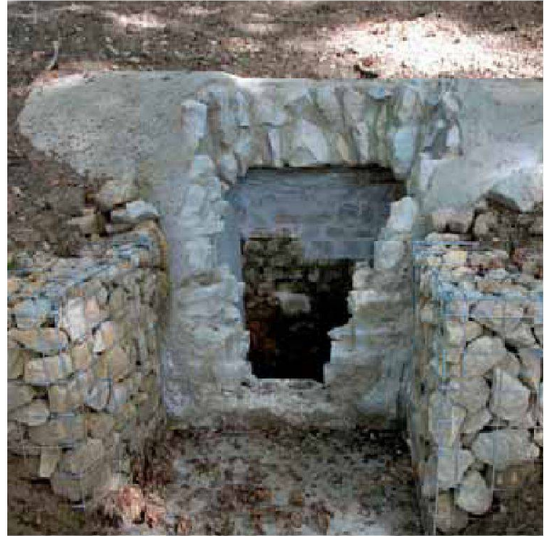
Abb. 48: Füllinsdorf-Wölferhölzli. Durch eine Restaurierungsaktion am römischen Aquädukt durch die Kantonsarchäologie Basel-Landschaft wurde 2006 der in den letzten Jahren zu beobachtende allmähliche Zerfall dieses Denkmals aufgehalten. Um weitere Einstürze zu verhindern, musste der Besucherzutritt seitlich vom Hang her statt von oben durch das Gewölbe angelegt werden.
