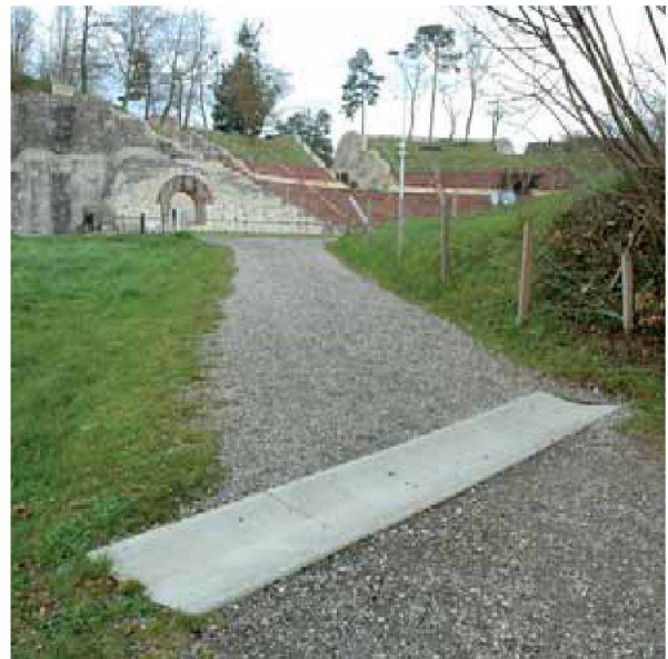
Abb. 62: Augst, Augusta Raurica. Auch der Zugangsweg zur «Römischen Brotbackstube» musste mit einer Regenrinne verbessert werden.
