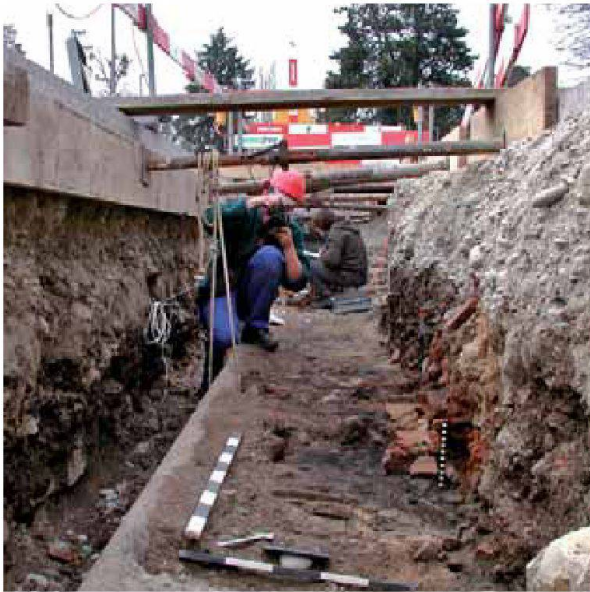
Abb. 38: Augst, Augusta Raurica, Leitungsgrabung (2006.053) in der Giebenacher- und in der Merkurstrasse. Wie in allen archäologischen Leitungsgrabungen ist derartiges Arbeiten und Dokumentieren kein Vergnügen: Es ist eng, die Schichten und Befunde sind oft von anderen modernen Eingriffen gestört, der Termindruck lastet auf dem Ausgrabungsteam, nie kann man eine Entdeckung im grösseren Kontext betrachten (und verstehen), die Anwohnerinnen und Anwohner sind ungeduldig ... Grabungsleiterin Anita Springer fotografiert einen brandverfärbten Ziegelversturz (vorne rechts) und die wissenschaftliche Zeichnerin Claude Spiess nimmt ein Grabenprofil massstabsgerecht auf.
