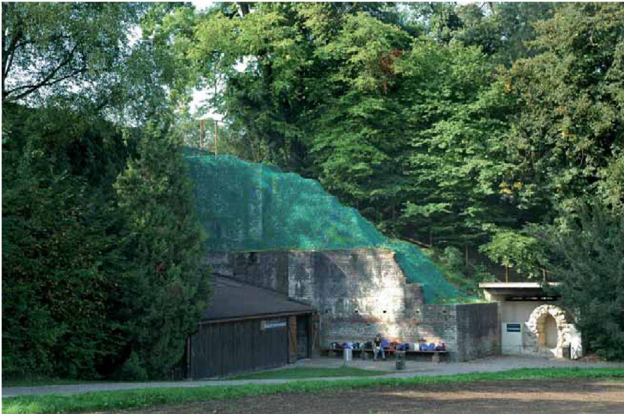
Abb. 52: Augst, Augusta Raurica. Die über 10 m hohe Stützmauer am Fuss des Schönbühl-Tempels ist Anfang des 20. Jahrhunderts restauriert worden. Wegen Einsturzgefahr (s. Abb. 51) mussten Teile davon 2006 provisorisch mit Netzen gesichert werden. Es ist vorgesehen, die Finanzierung zu sichern und diese Gefahrenzone in den nächsten Jahren zu sanieren. Dabei muss auch das Teilstück der römischen Wasserleitung Lausen–Augusta Raurica (rechts) versetzt werden.
