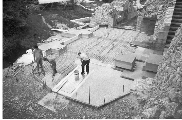
Abb. 28: Augst, Theatersanierung (Grabung 2004.055). Ausgestaltung der Bodenbeläge: Einbringen des hellen Bodenbelags im Bereich der ehemals durch ein Tonnengewölbe überspannten Südhalle. Zur Stabilisierung wird im Bodenbelag ein leichtes Eisennetz eingelegt. Übersicht von Südosten.
