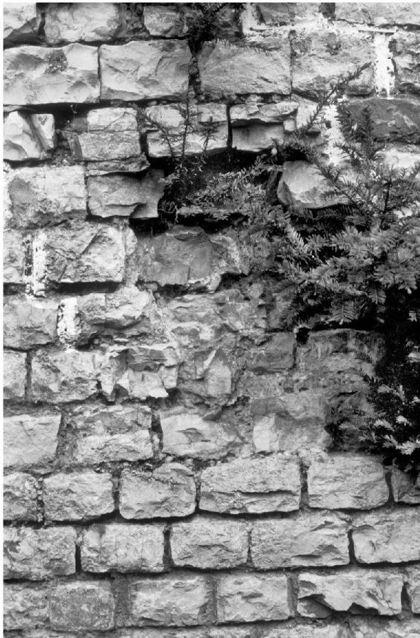
Abb. 21: Augst, Theatersanierung (Grabung 1995.055). Grundlagen zur Erarbeitung eines Auswertungskonzepts. Typisches Schadensbild am Mauerwerk des jüngeren szenischen Theaters; entstanden durch Frostsprengungen und wild wuchernden Pflanzenbewuchs.
