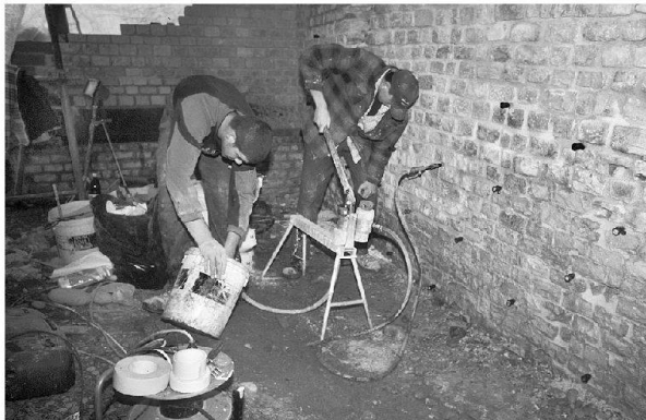
Abb. 47: Augst, Theatersanierung (Grabung 2004.055). Peripheriebereich Keil 4 (MR 58): Einpumpen des Injektionsmörtels in die Mauerkluff; an der Handkolbenpumpe arbeiten Dominik Fux und Mubekir Hajrzi. Blick von Osten, im Hintergrund Pfeiler MR 196.
