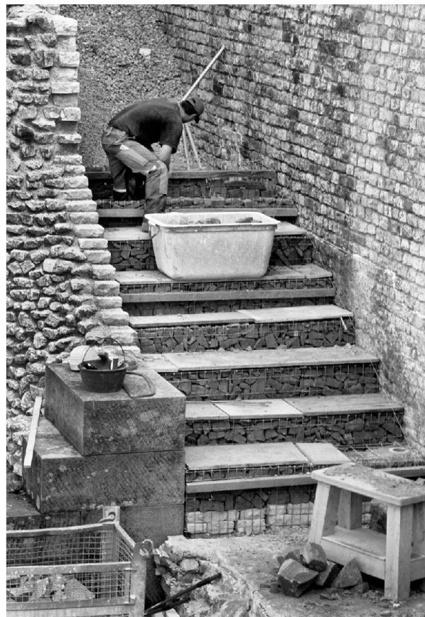
Abb. 33: Augst, Theatersanierung (Grabung 2003.55). Südhalle: Treppe zum Diazoma-Umgang (Umgang der ersten praecinctio). Die Gitterkorbkonstruktion der modernen Treppe im Aufbau.
