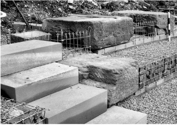
Abb. 28: Augst, Theatersanierung (Grabung 2003.55). Rekonstruktion der Sitzstufen im zweiten Rang. Detail der Aufbauarbeiten in Keil 3. Aus didaktischen Gründen erfolgte eine Integration von drei originalen Sitzstufenquadern aus Buntsandstein in die moderne Gitterkorbkonstruktion.
