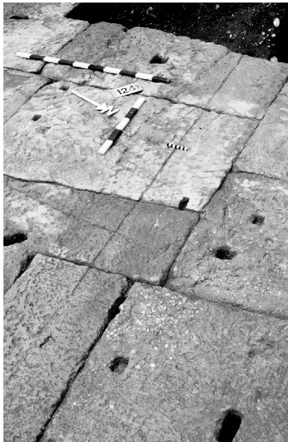
Abb. 10: Augst, Theatersanierung (Grabung 2003.55). Quaderfundamente der südlichen Eingangshalle. Detail mit breiter Quaderarbeitung und deutlicher, quer über das Fundament verlaufender Risslinie.
