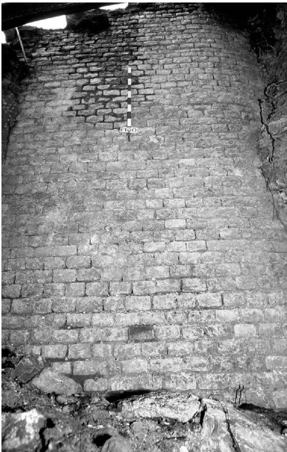
Abb. 19: Augst, Theatersanierung (Grabung 2003.55). Einsturztrichter im zweiten Rang – Keil 1. Ansicht an die östliche, sorgfältig aus Muschelkalk-Handquadem gefügte Mauerschale von MR 65.
