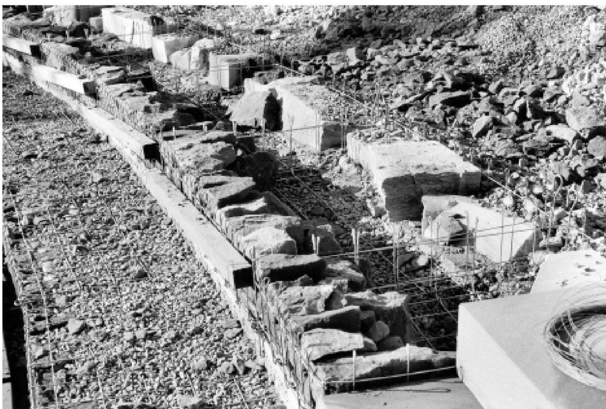
Abb. 22: Augst, Theatersanierung (Grabung 2001.55). Moderne Sitzstufenrekonstruktion. Fertig geschichtete Sandsteinfüllungen an den Stirnseiten der Körbe. Die festgebundenen Holzbalken verhindern ein Ausbauchen der Gitterkörbe während den Füllarbeiten.
