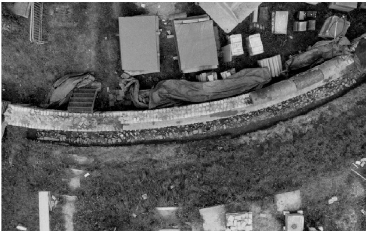
Abb. 40: Augst, Theatersanierung (Grabung 2001.55). Bereich ausserhalb der Podiumsmauer des Amphitheaters (Feld 183). Aufsicht auf die Podiumsmauer MR 38 und das Fundament an der Aussenseite der Podiumsmauer.
