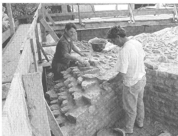
Abb. 41: Augst, E. Frey AG (Grabung 1997.60/1998.60/1999.60). Avelino und Antonio de Matos Cruz beim Konservieren der älteren Hangstützmauer 16 (Abb. 1; 38; 39, links). Rechts ist einer der Strebepfeiler erkennbar (MR 24).
