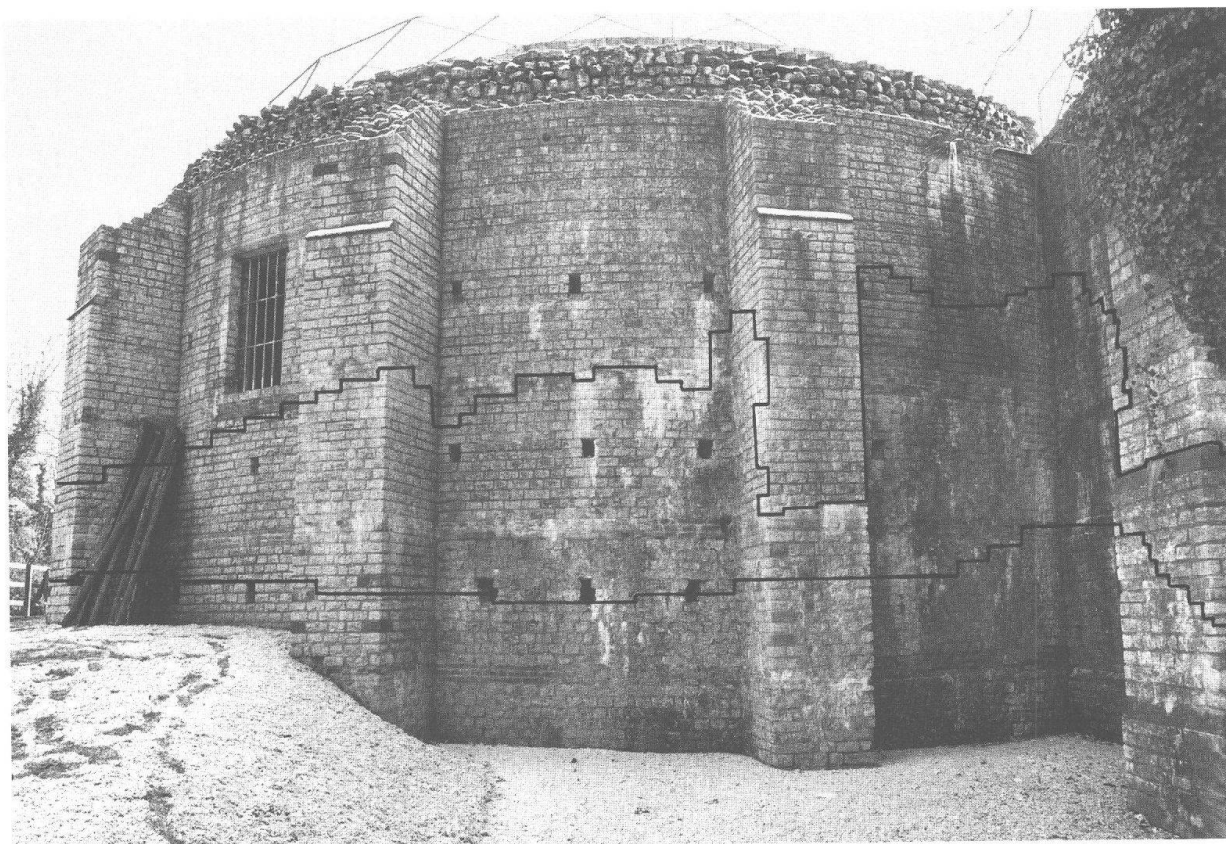
Abb. 6: Augst BL, Curia-Schutzdach (Grabung 1998.51). Ansicht der Curia von Norden nach der Wiederherstellung der Umgebung zum Schluss der Arbeiten. Die untere Linie markiert die Terrainoberfläche im Jahr 1941 vor den Abgrabungen durch R. Laur-Belart. Die obere Linie bezeichnet den ungefähren Höhenverlauf, ab der die Mauerschale erneuert wurde.
