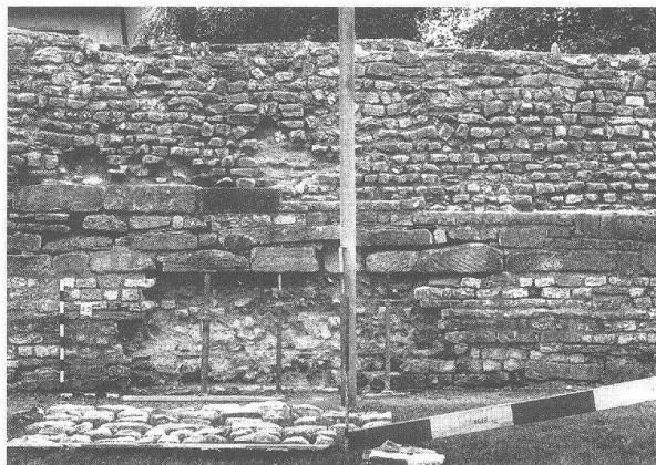
Abb. 3 Kaiseraugst, Sanierung Kastellmauer (Grabung 1994.07). Ausgebaute schadhafte Stelle. Die einzelnen Steinlagen werden stückweise davor deponiert, um danach möglichst mit Originalsubstanz in ursprünglicher Lage eingebaut zu werden.
