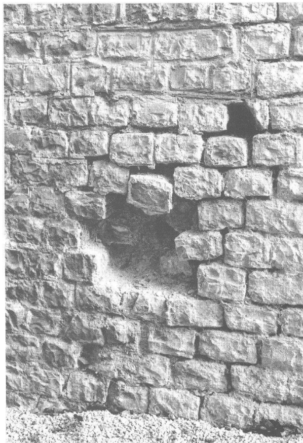
Abb. 4 Augst BL, Theater. Ausbrüche in der Nordwange des Süd vomitoriums mussten im Jahr 1991 plötzlich festgestellt werden.
