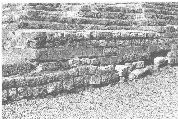
Abb. 3 Augst BL, Theater. Schäden an der Innenseite der nordwestlichen Abschlussmauer.
