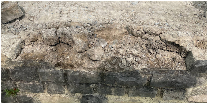
Abb. 6: Augst BL, Grienmatt (Monumentenrestaurierung 904.2022.01). Aufmauerungen aus den frühen 1960er-Jahren. Der extrem sandige Zementmörtel ist vollständig zerkrümelt und die Schalenquader haben kaum noch Halt.
