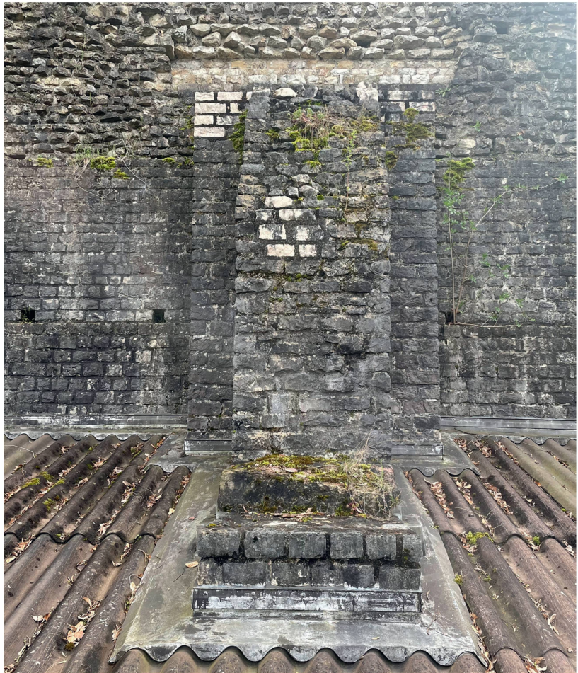
Abb. 2: Augst BL, Schönbühl-Brotbackstube (Monumentenrestaurierung 903.2022.01). Stützpfiler der Terrassenmauer auf der Nordseite des Schönbühlabhangs vor Beginn der Arbeiten. Die Maueroberflächen sind defekt und rissig, Moose und andere Vegetation haben sich im Laufe der Zeit in den Fugen des Mauerwerks festgesetzt. Feuchte Stellen zeigen, dass Wasser in den Mauerkern eintritt.
