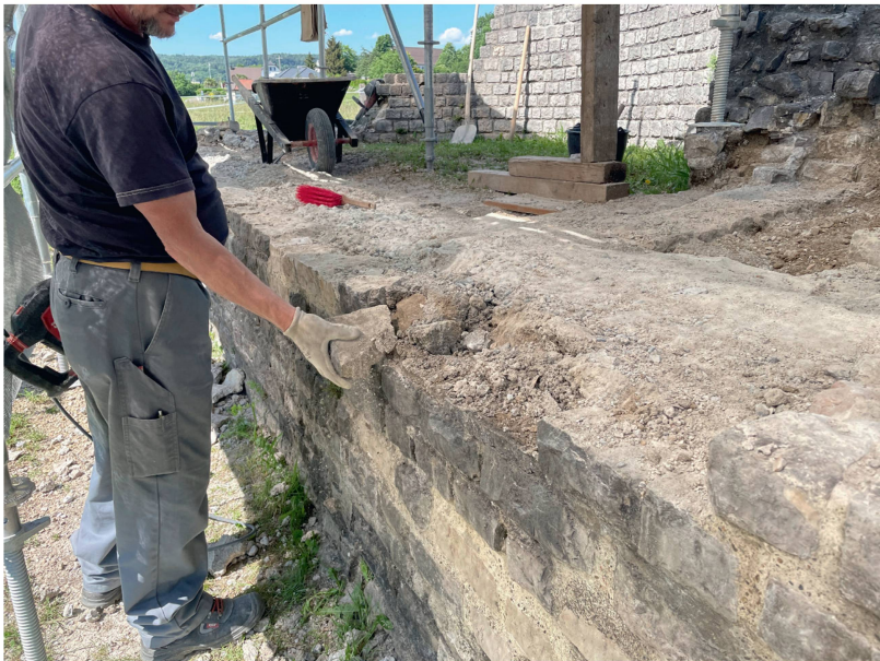
Abb. 7: Augst BL, Grienmatt (Monumentenrestaurierung 904.2022.01). Aufmauerungen aus den frühen 1960er-Jahren. Der Zustand des rekonstruierten Mauerwerks ist stellenweise derart schlecht, dass sich die Mauer mit blossen Händen abbauen lässt.
