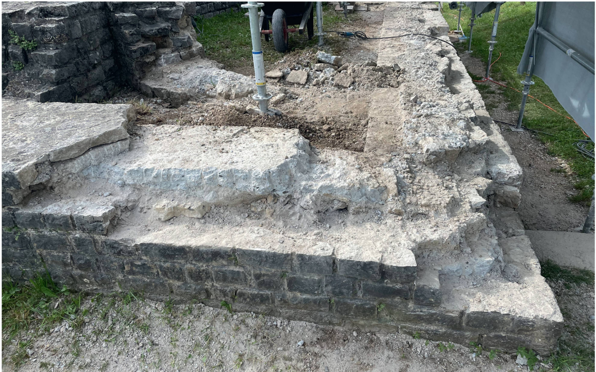
Abb. 9: Augst BL, Grienmatt (Monumentenrestaurierung 904.2022.01). Zustand nach Abbau der Altrestaurierungen aus den frühen 1960er-Jahren bis auf das Niveau des soliden Mauerwerks. Im Mauerwerk finden sich diverse Hohlstellen und Zonen mit stark sandigem Mörtel. Deutlich erkennbar ist die Ablösung der Überkronung vom darunterliegenden Betonkern (links im Bild).
