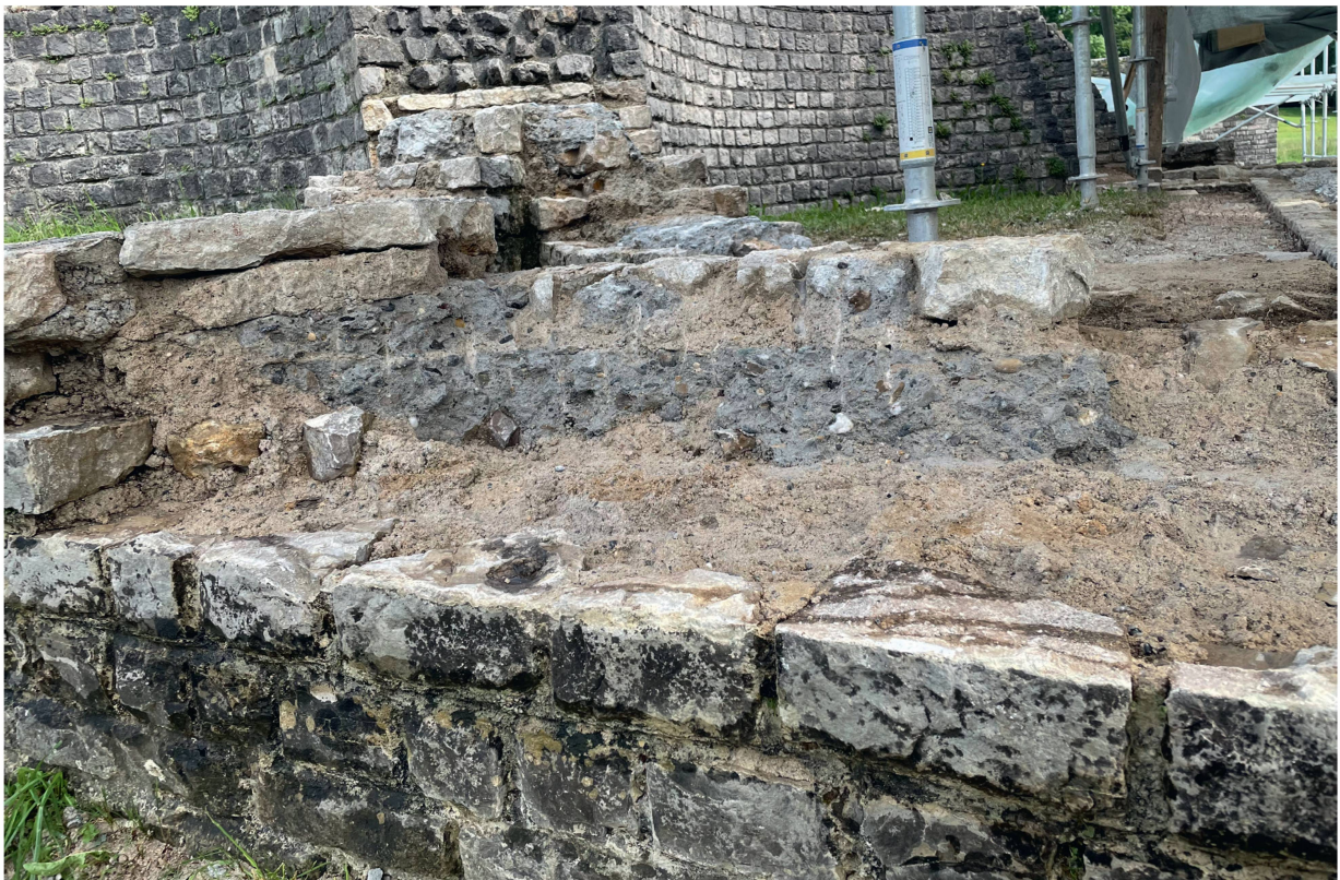
Abb. 5: Augst BL, Grienmatt (Monumentenrestaurierung 904.2022.01). Zustand der defekten Restaurierungen aus den frühen 1960er-Jahren. Die verwendeten Materialien sind sehr heterogen und das spärliche Steinmaterial ist zum Teil von schlechter Qualität. Im Kern wurden unterschiedliche, mehr oder weniger stark zementhaltige Mörtelmischungen verbaut. Der auffällig sandige, hellbräunliche Mörtel enthielt einen derart geringen Zementanteil, dass er kaum noch Bindefähigkeit besass.
