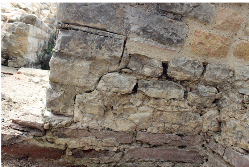
Abb. 11: Augst BL, Forum (Monumentenrestaurierung 906.2019.01). Treppenhaus der Basilica. Gewände des Türdurchgangs zum Treppenhaus mit vom antiken Mauerwerk abgelöster moderner Zementrestaurierung.
