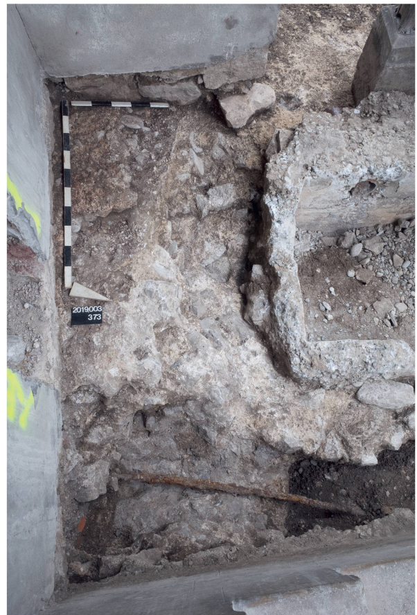
Abb. 18: Kaiseraugst AG, Bolingerhaus (Grabung 2019.003). Detail des Ansatzes von Turm 10 mit den Resten des Mörtelgussbodens sowie den Eisenoxid-ausfällungen. Im unteren Bildbereich sind eine alte Stromleitung sowie im mittleren Bildbereich ein in die Kastellmauer eingeschroteter Sickerschacht erkennbar. Norden ist rechts unten.
