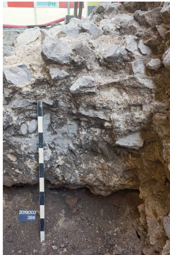
Abb. 14: Kaiseraugst AG, Bolingerhaus (Grabung 2019.003). Ansicht auf das infolge Beraubung der Mauerschale freiliegende Gussmauerwerk des Osthauptes der Kastellmauer mit deutlich erkennbarer Unterminierung im Fundamentbereich. Norden ist rechts.
