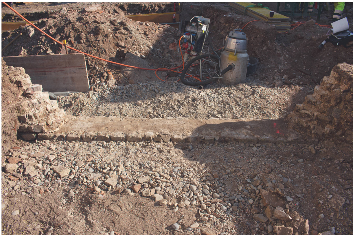
Abb. 51: Augst BL, Anbauten Giebenacherstrasse 26 II (Baubegleitung 2019.053). Blick von Nordosten auf die partiell abgebrochene Mauer MR 14.
