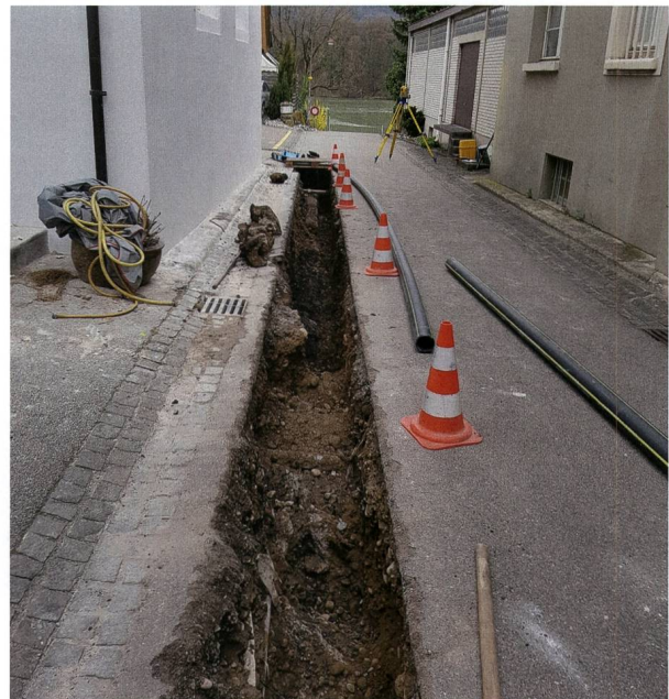
Abb. 16: Kaiseraugst AG, Gasleitung Tränkasse (Begleitung 2017.004). Blick von Süden in die Tränkasse mit offenem Leitungsgraben.
