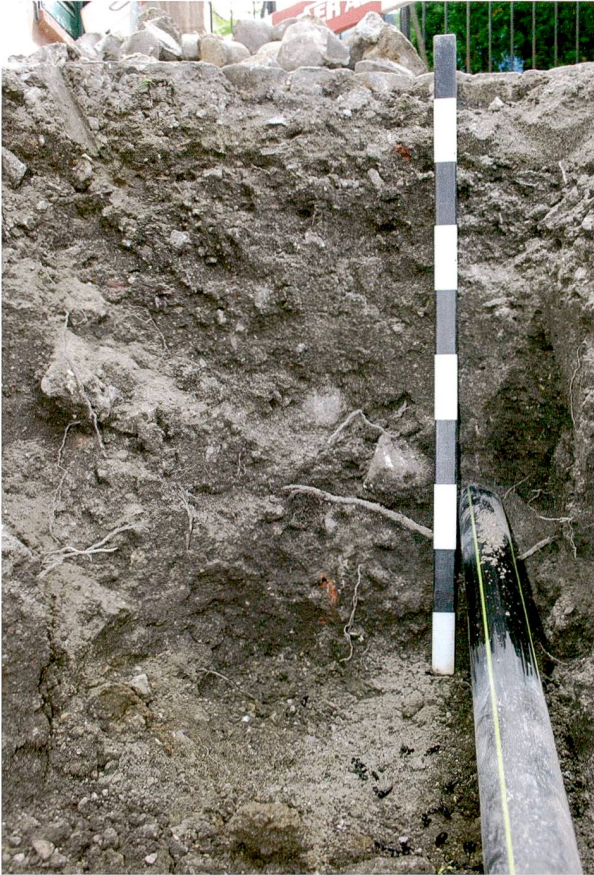
Abb. 86: Augst BL, Ehingerhof Gasleitungsleck (Baubegleitung 2016.067). Blick von Norden an die südliche Grabungsgrenze. Der Leitungsgraben zeichnet sich im dunkelbraunen Boden nicht ab.
