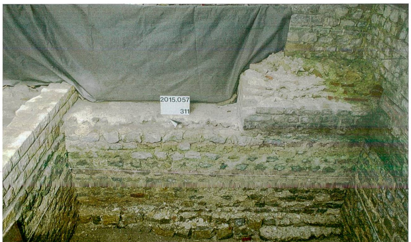
Abb. 53: Augst BL, Basilica-Stützmauern (Grabung 2015.057). Obwohl als spätere Zutat eingebaut, wurde MR 15 tief fundamementiert, wie die Sondierung in Feld 13 zeigt. Von Südwesten.
