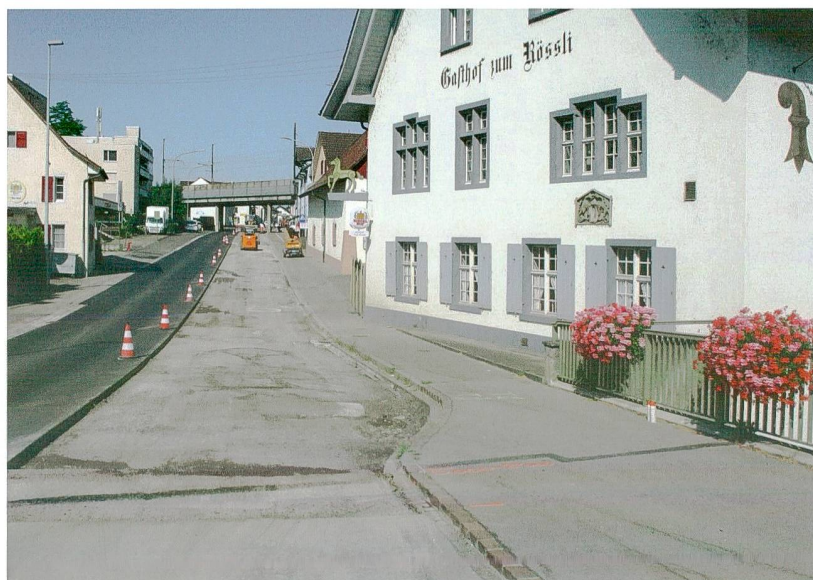
Abb. 83: Augst BL, Hauptstrasse Belagserneuerung (Grabung 2015.061). Der Belag auf der nördlichen Fahrbahn ist abgefräst (rechts), die südliche Fahrbahn weist bereits den neuen Belag auf (links). Von Osten.
