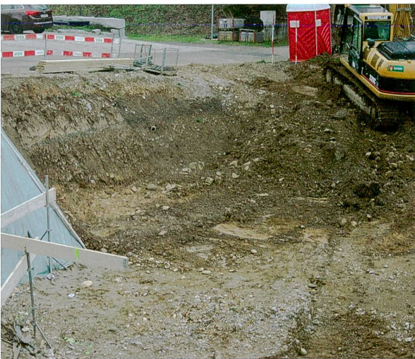
Abb. 23: Augst BL, Hausmatt (Grabung 2015.053). Aushubarbeiten am nördlichen Rand der Baugrube. Oben von links nach rechts laufend der Hausmattweg. Von Westen.
