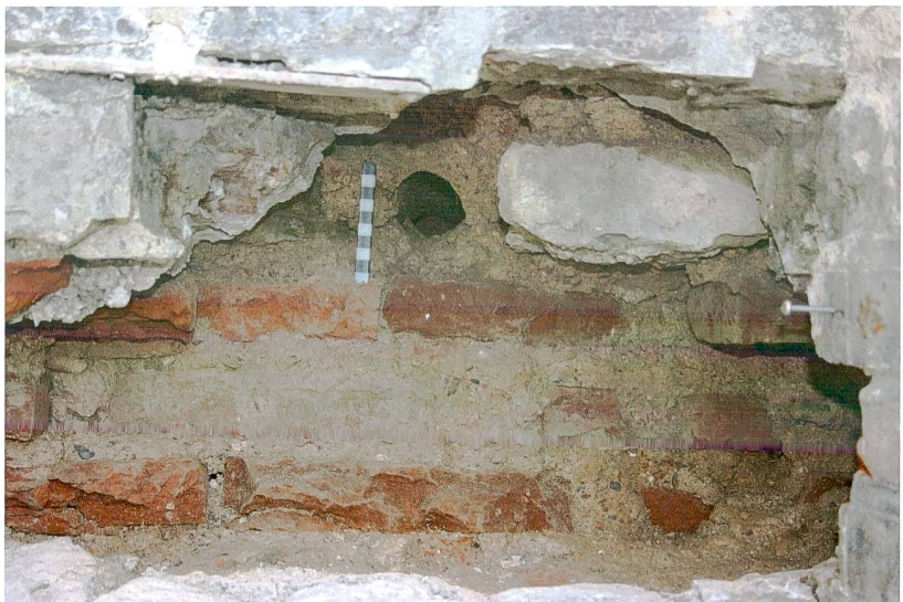
Abb. 58: Augst BL, Stützmauern Basilica (Grabung 2014.057). Nach dem Rückbau der konservierenden Mauerschale von 1941 sichtbar gewordenes originales Gerüstloch in MR 31 (Nordseite). Von Nordwesten.
