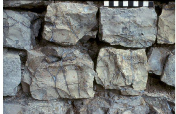
Abb. 59: Augst, Theatersanierung (Grabung 1992–2007.055). Die Kalkstein-Handquader der Mauerschalen weisen durch Alter und Witterung, aber auch durch Frosteinwirkung unzählige Haarrisse auf. In aufwendiger Feinarbeit wurden die Steinstücke verklebt und die Mauerschalen so wieder geschlossen.
