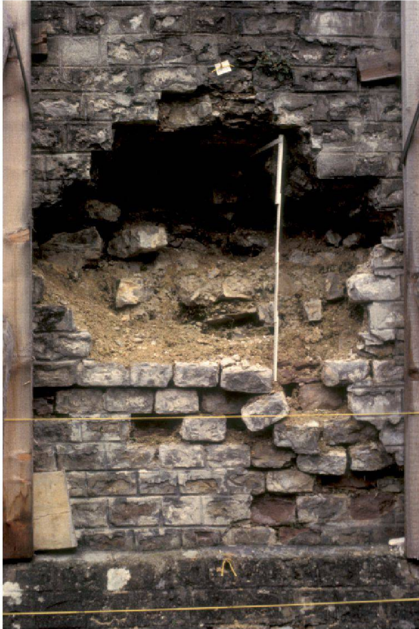
Abb. 49: Augst, Theatersanierung (Grabung 1992–2007.055). Mauerausbruch durch Frostsprengung in der Mauerschale von Mauer MR 44/200. Blick von Westen. Zustand bei Beginn der Sanierungsarbeiten.
