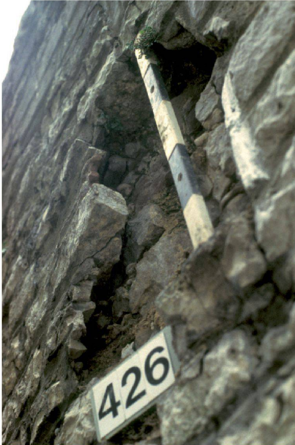
Abb. 58: Augst, Theatersanierung (Grabung 1992–2007.055). Typisches Schadensbild durch Frostsprengung mit Ablösung einer grösseren Schalenplatte an der Ostseite von Mauer MR 2. Zustand bei Beginn der Sanierungsarbeiten.
