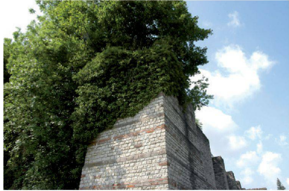
Abb. 93: Augst, Augusta Raurica. Der Pflanzenbewuchs auf der Krone der Basilica-Nordmauer verursacht viel Schaden an der Verblendung wie auch im Mauerkern.
