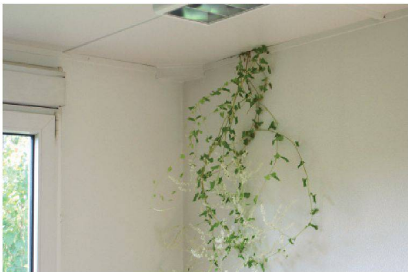
Abb. 20: Büro der Bereichsleiterin für Bildung & Vermittlung im selben Container: Die Containerwände sind defekt, die Wärmedämmung darin ist längst mangelhaft, die Kletterpflanze an der Aussenfassade findet ihren Weg ins Büroinnere.
