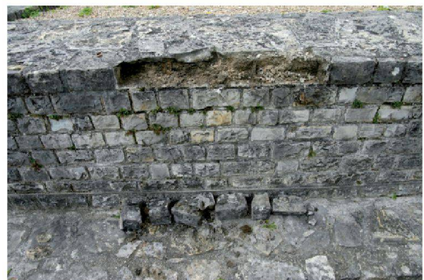
Abb. 90: Augst, Augusta Raurica, Tempelanlage Grienmatt. Vermehrt lösen sich an den modernen Mauerkronen Steine wegen Wasser, Frosteinwirkung und Abnutzung durch die Besuchenden.
