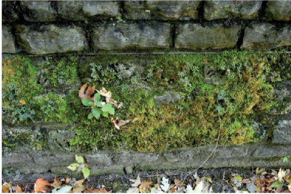
Abb. 97: Kaiseraugst-Dorf, Augusta Raurica. Der Moosbefall an diversen Stellen der spätantiken Kastellmauer muss dringend entfernt werden.
