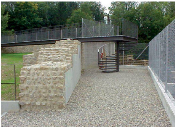
Abb. 99: Augst, Augusta Raurica. Der bisher hier ausgebrachte Splittbelag beim Zugang zum Unterirdischen Brunnhaus wurde leider als Inspiration zum mutwilligen Steinewerfen missbraucht: Defekte Autos, zersplitterte Fensterscheiben und Reklamationen waren die Folge (s. Abb. 100).
