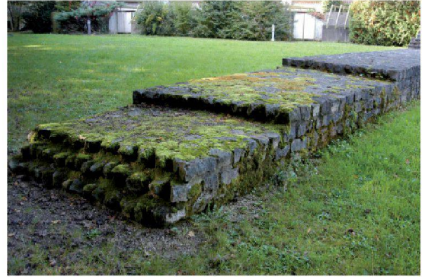
Abb. 98: Kaiseraugst, Augusta Raurica. Auch an der kaiserzeitlichen Stadtmauer in der Liebrüti mussten wir das stark wuchernde Moos entfernen.
