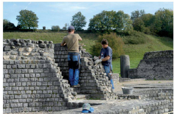
Abb. 91: Augst, Augusta Raurica. Konservierungsarbeiten am Podium des Grienmatt-Heiligtums durch Remo Plattner und Ismet Muhadini von der Bauunternehmung Markus Fux AG.
