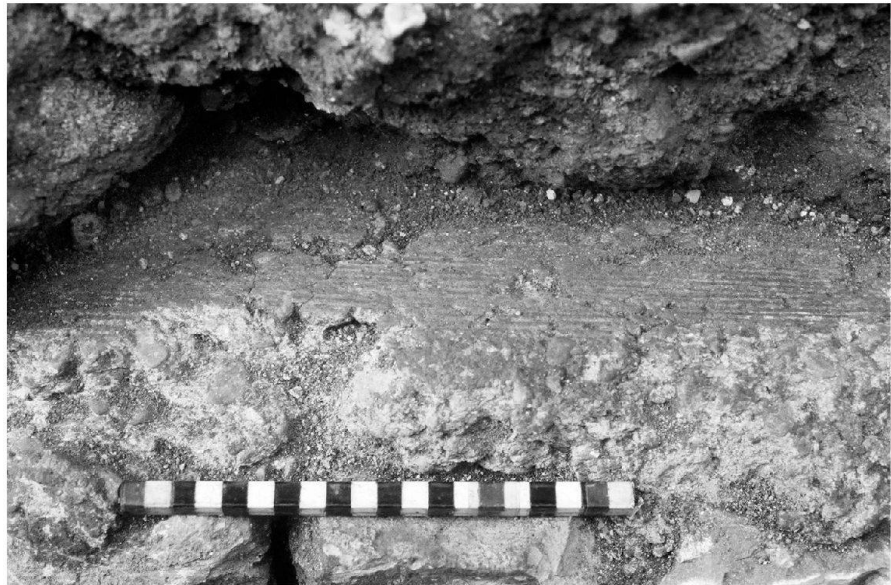
Abb. 14: Augst BL, Wasserleitung Giebenacherstrasse (Grabung 2003.51). Mauer MR 7 mit einer Mörtelabdeckung, die Abdrücke eines Holzbalkens zeigt; hier der westliche Teil des Abdrucks in einer Detailaufnahme. Von Süden.
