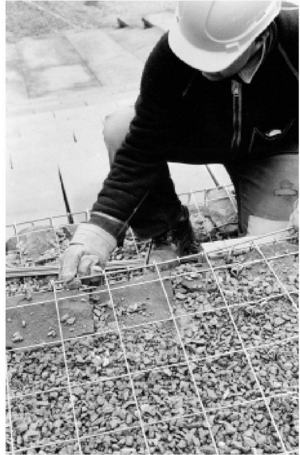
Abb. 24: Augst, Theatersanierung (Grabung 2001.55). Moderne Sitzstufenrekonstruktion. Einsetzen und Verschliessen des Deckels und Auffüllen des Korbs mit Granitschotter und -splitt.
