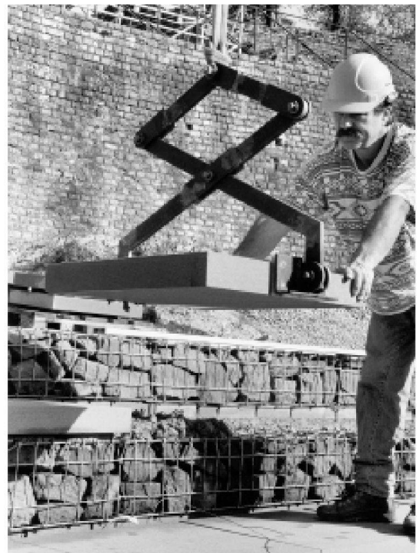
► Abb. 25: Augst, Theatersanierung (Grabung 2001.55). Moderne Sitzstufenrekonstruktion. Versetzen der Abdeckplatten aus Buntsandstein. Die Platten werden mit Hilfe einer modernen Zange in ein Mörtelbett gesetzt.
