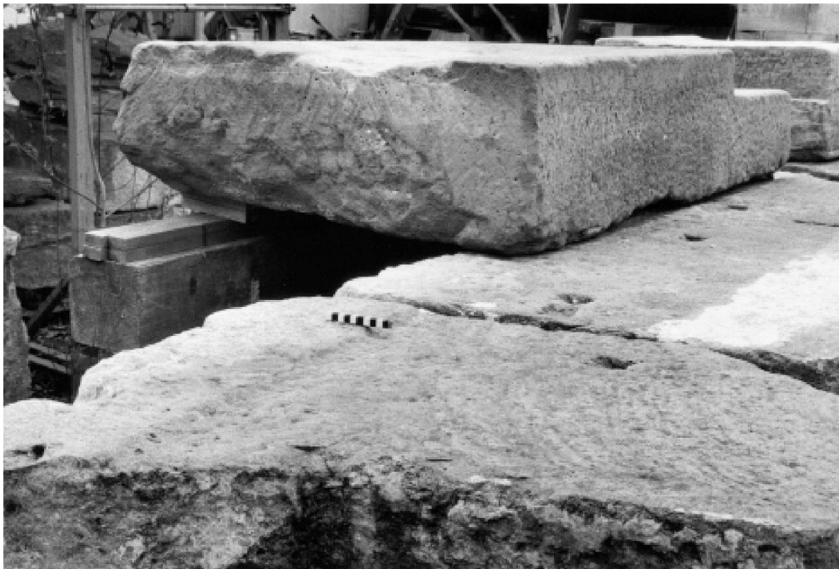
Abb. 4: Augst, Theatersanierung (Grabung 2001.55). Architekturprobe unter Verwendung von originalen Sitzstufenquadern des jüngeren szenischen Theaters. Oben ein grosser Stufenquader mit ausgehauenen Treppentritt (am rechten Bildrand), fein gespitzter Stirnseite und Seitenfläche mit dreiseitiger Anathyrose. Unten Oberflächen von zwei Sitzstufenquadern mit Glättung als Auflager für die nächsthöhere Sitzstufenreihe und davor liegenden Stemmlöchern.
