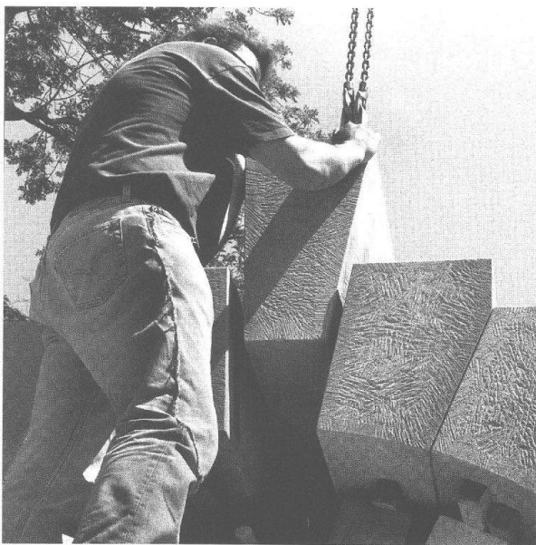
Abb. 25: Augst, Theatersanierung (Grabung 2000.55). Rekonstruktion des Werksteinbogens am Mündungsbereich des Südost-Vomitoriums. Der Schlussstein wird vorsichtig in die Lücke am Scheitelpunkt des Bogens eingeschoben.
