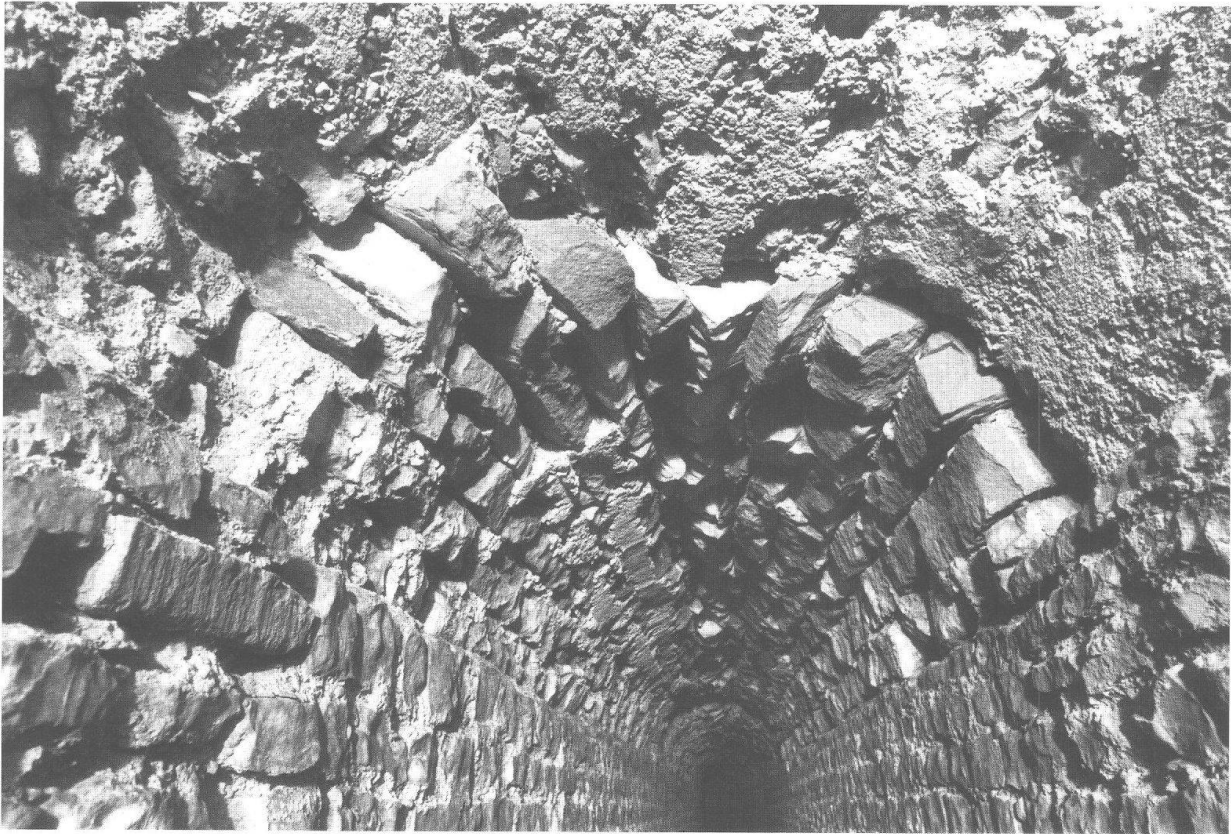
Abb. 5: Augst, Theatersanierung (Grabung 2000.55). Nordabschnitt des Abwasserkanals. Fuge zwischen älterem Sandstein- und jüngerem Kalkgussgewölbe.
