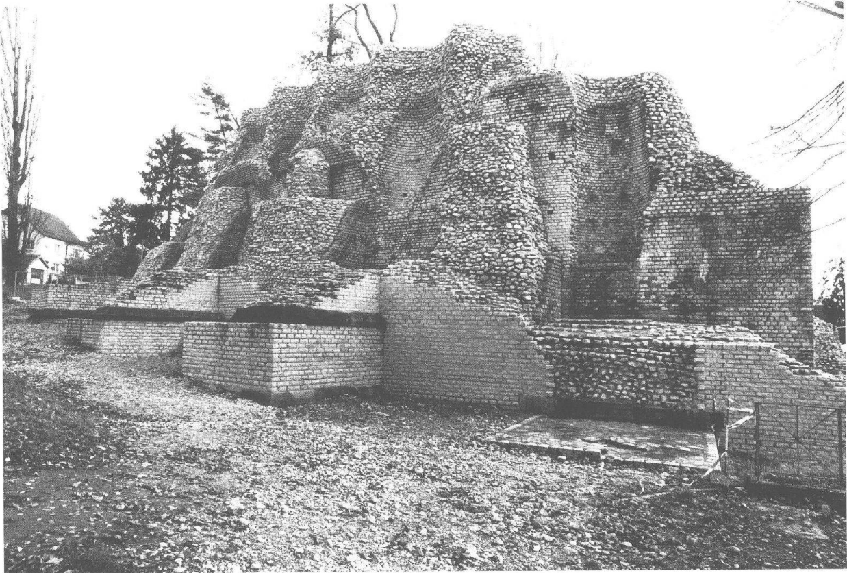
Abb. 31: Augst, Theatersanierung (Grabung 2000.55). Aussenmauern im Keil 1 (Abb. 1,C). Übersicht von Nordwesten nach Abschluss der Sanierungsarbeiten im Spätherbst.
