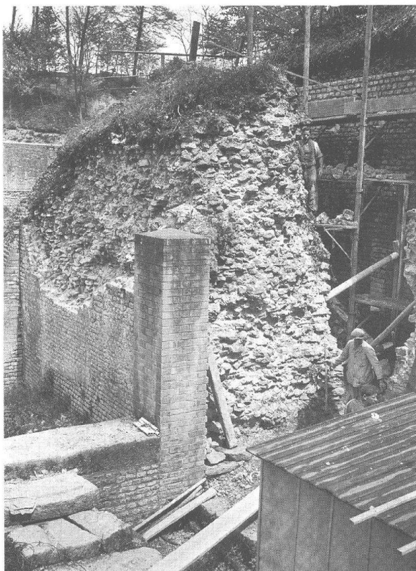
Abb. 31: Augst, Theatersanierung (Grabung 1936.59). Südaditus. Die innere Bühnenmauer (MR 43) 1936 vor den Restaurierungsarbeiten. Blick von Süden.
