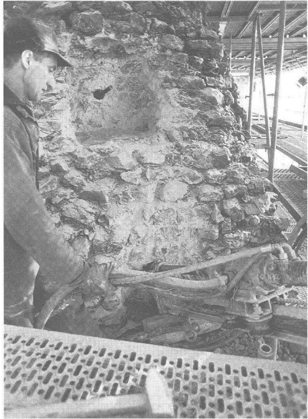
Abb. 40: Augst, Theatersanierung (Grabung 1997.55). Nördliche Cavea-Abschlussmauer (MR 60). Bohrmeister in Aktion. Die Löcher für die Erdanker werden an genau bezeichneten Punkten mit einer Neigung von 15° quer durch die moderne Vormauerung und das Originalmauerwerk bis tief in die Keilfüllung vorgebohrt.
