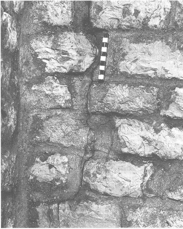
Abb. 39: Augst, Theatersanierung (Grabung 1997.55). Nördliche Cavea-Abschlussmauer (MR 60). Detail mit vertikal durch mehrere Steinschichten verlaufendem Riss in einem Entlastungsbogen. M. 1 : 5.
