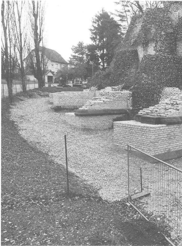
Abb. 36: Augst, Theatersanierung (Grabung 1997.55) Die Stützpfeiler nördlich der Umfassungsmauer (MR 57) nach Beendigung der Arbeiten. Das Gelniveau liegt jetzt ca. 1,50 m höher. Die stark bröckeligen, zum Teil noch originalen Partien am Fuss der Umfassungsmauer sind jetzt dauerhaft geschützt.
