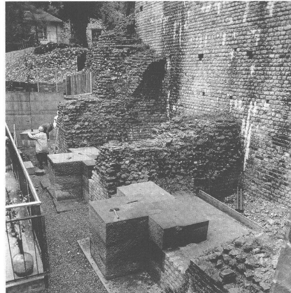
Abb. 14 Augst, Theatersanierung (Grabung 1996.55). Verstärkungen im Fundamentbereich der nördlichen Cavea-Abschlussmauer. Im Vordergrund die fertig versetzten Sandsteinblöcke des südlichen Pfeilerfundamentes mit der Hinterfüllung aus Stampfbeton.
