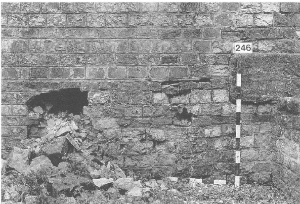
Abb. 4 Augst, Theatersanierung (Grabung 1996.55). Detail aus dem Fundamentbereich der äusseren Peripheriemauer (MR 57) des ersten Keils. Zustand im Frühjahr 1996: Durch die abgeplatzte äussere Mauerschale quillt der aufgelöste Mauerkernel heraus.
