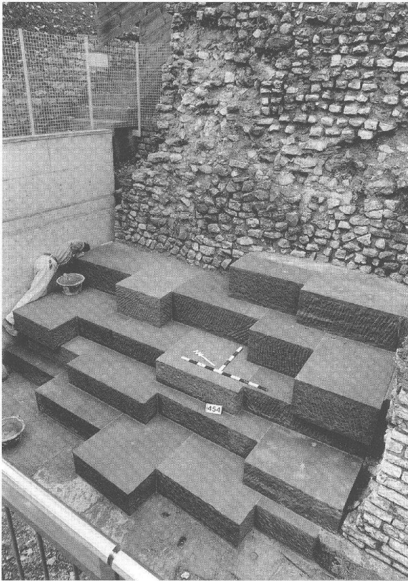
Abb. 15 Augst, Theatersanierung (Grabung 1996.55). Verstärkungen im Fundamentbereich der nördlichen Cavea-Abschlussmauer. Fertig versetzte Sandsteinquader auf dem nördlichen Pfeilerfundament. Ausdehnung und Aussehen dieses Pfeilers sind unbekannt. Deshalb wurde die aus statischen Gründen notwendige Ergänzung als unfertiges Fundament gestaltet. Die Dimension der Quader und der Fugenschnitt folgen, soweit rekonstruierbar, dem Originalbefund.
