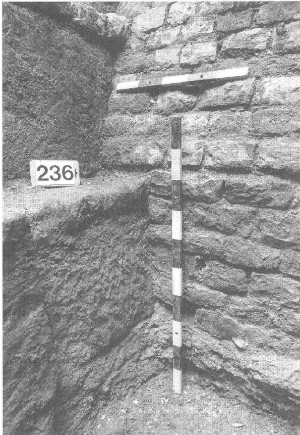
Abb. 6 Augst, Theatersanierung (Grabung 1994.55). Ansicht von Südwesten an den «Eckverband» von MR 245 und MR 1/MR 244. Erkennbar sind links die Überreste der älteren Pfeilerphase (MR 245), die ursprünglich aus mindestens zwei Lagen von Buntsandsteinquadern bestand. In der rechten Bildhälfte ist die gleichzeitig mit MR 245 entstandene Mauer 244 zu sehen, darüber die schräg verlaufende, zehn Steinlagen starke Abfasung in der Aditusmauer MR 1/MR 244.
