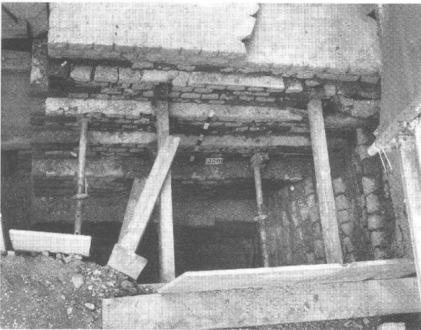
Abb. 3 Augst, Theatersanierung (Grabung 1994.55). Aufsicht auf die Grabungsfläche und den abgetreppten Stützfeiler MR 14/MR 245/MR 250. An der Unterkante des Pfeilers ist die aus grossen Buntsandsteinquadern bestehende ältere Bauphase (MR 245) zu erkennen. Am rechten Bildrand erkennt man die schräg verlaufende Abfasung in MR 1/MR 244.
