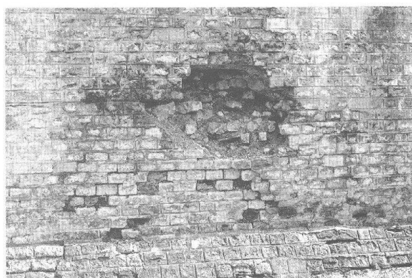
Abb. 5 Augst BL, Theater. Die Schäden an der Aussenseite der südwestlichen Abschlussmauer lassen sich auf die Spannungen zwischen römischem Kalkmörtel und modernem Zement zurückführen.
