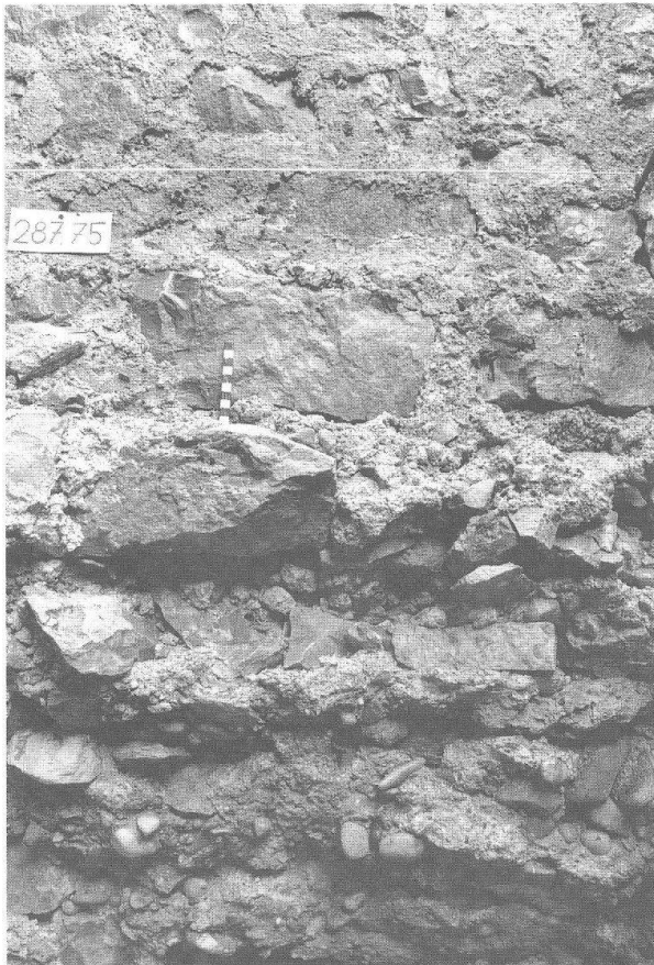
Abb. 23 Augst BL, Grabung 1990.53. Detail an der jüngeren Basilika-Stützmauer. Im unteren Bildteil ist das leicht einziehende, direkt in die Baugrube gemauerte Fundament zu erkennen. Der fast noch in baufrischem Zustand erhaltene untere Teil des aufgehenden Mauerwerkes ist – wie u.a. auch die anhaftenden Kiesel zeigen – unmittelbar nach dem Hochziehen der Mauer wieder mit angeböschtem Erdreich verdeckt worden (vgl. auch Abb. 20,C). Blick nach Westen.
