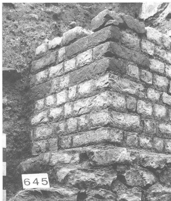
Abb. 35 Augst BL, Grabung 1990.51, Fläche 3. Detail des z.T. aus Sandsteinen bestehenden Eckverbandes von Strebepfeiler 2.
