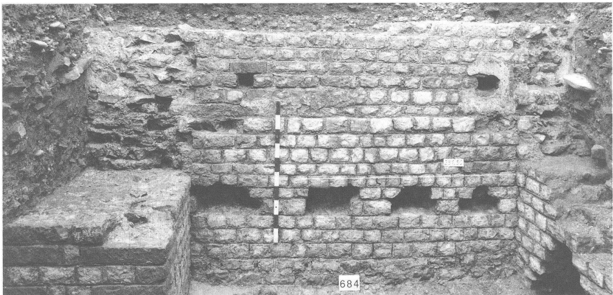
Abb. 53 Augst BL, Grabung 1990.51, Fläche 3. Ansicht der Umfassungsmauer 3 des 1. Theaters in Phase 8. Deutlich zu erkennen sind die beim Abruch der Strebepfeiler 1 und 2 (MR 4 und 9) entstandenen Ausbrüche in der Umfassungsmauer 3, die aus der Bauzeit (Phase 4) stammenden Gerüstbalkenlöcher und die in Phase 6 ausgebrochenen Balkenlager der Kanalabdeckung.
