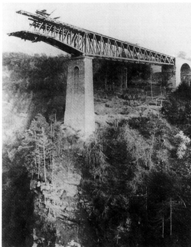
Fig. 29 Le pont de Fenil au moment du montage de la partie métallique fin 1903.
