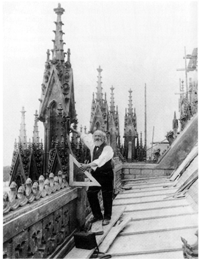
Fig. 14 Ingénieur? Architecte? Sur le chantier de l'Eglise Notre-Dame, Guillaume Ritter allie les deux approches, vers 1900 (2.6.2). Photographie anonyme (Paroisse catholique).
