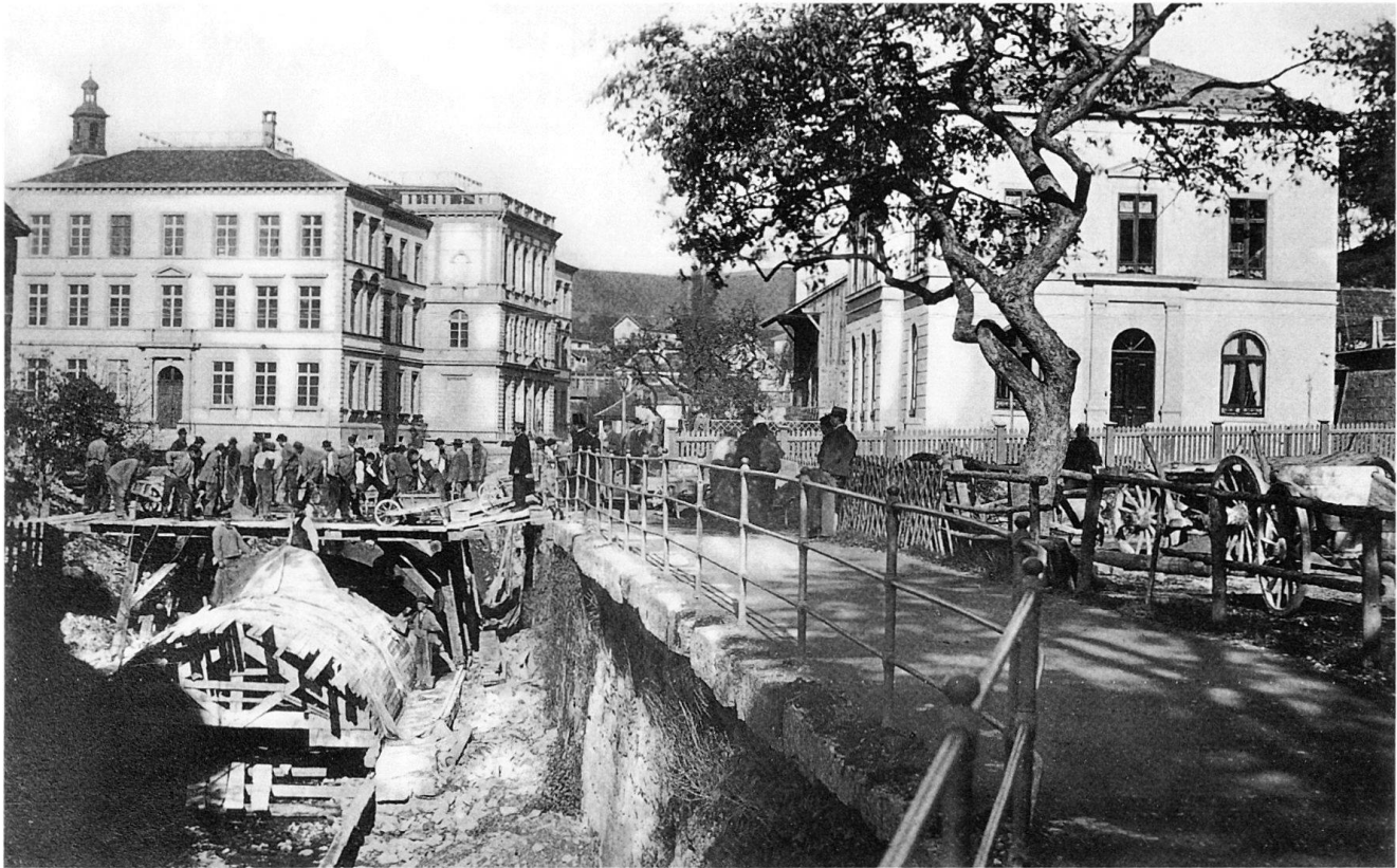
Abb. 13 Aufnahme der Bachstrasse während der vierten Etappe der Gerberbach-Einwölbung (1871–1873). Links das Mädchen-schulhaus, rechts das Pfarrhaus, beide erbaut von Johann Gottfried Meyer. Foto Carl Koch.
