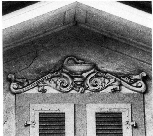
Abb. 13 Grenchen, Bahnhofstrasse Nr. 53. Wohnhaus des Arztes und Uhrenpioniers Dr. med. Josef (II.) Girard (1803–1869), erbaut 1863. Giebelrelief mit Aeskulapuschlange.
