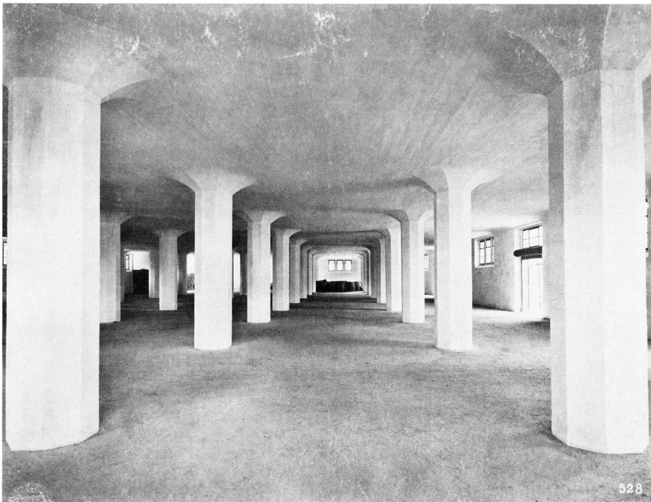
Abb. 51 Aldorf. Sacklagergebäude der Eidg. Getreidemagazine, erbaut 1912–1913 vom Ingenieurbüro Robert Maillart & Cie (Zürich und St. Gallen). Pilzdeckenkonstruktion des Erdgeschosses. Photographie um 1913 (vgl. Abb. 50, 58, 59).
