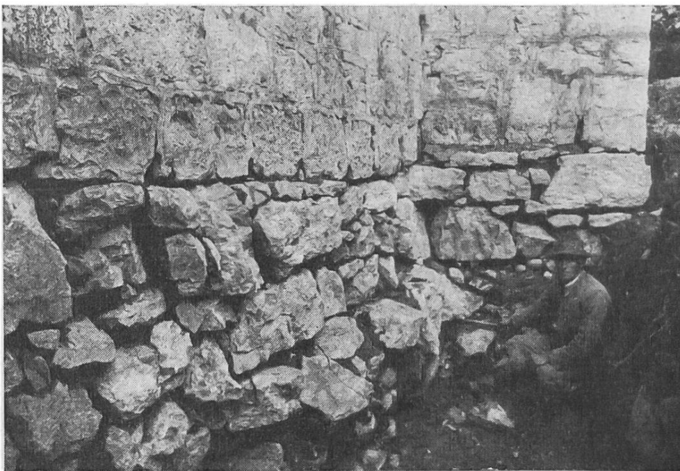
Die kranken Fundamente der Kirche Zürich-Verlifen
