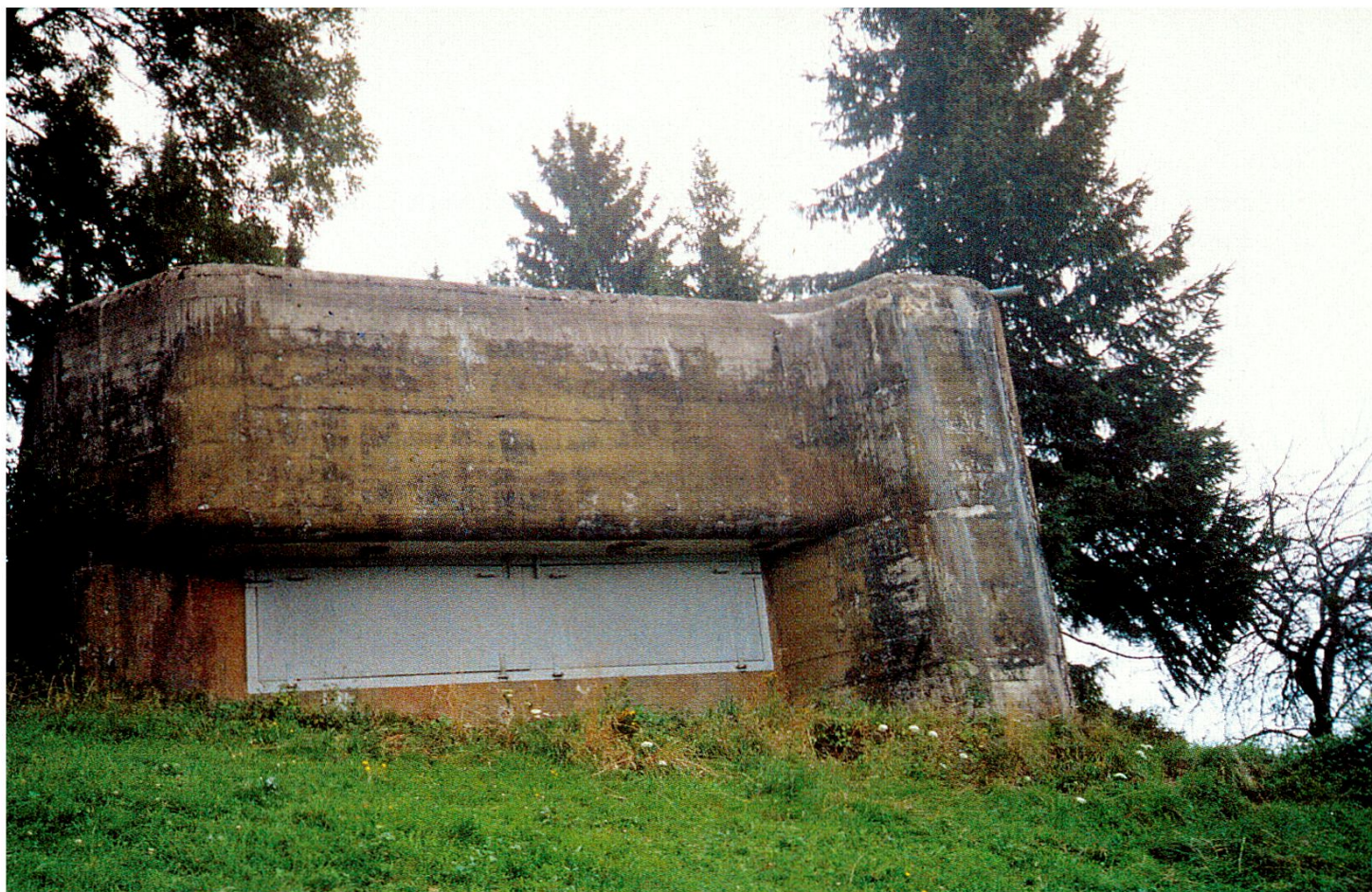
Der Bunker «Stoss-Warmesberg», der umfangreichste in der Sperre, weist eine Betonkubatur von über 1200 m 3 auf.
